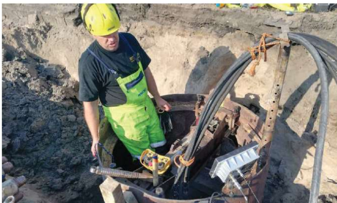
Wykonywanie wiercenia pilotażowego wiertnicą umieszczoną w adapterze, umożliwiającym wykonywanie instalacji także z wykopów
